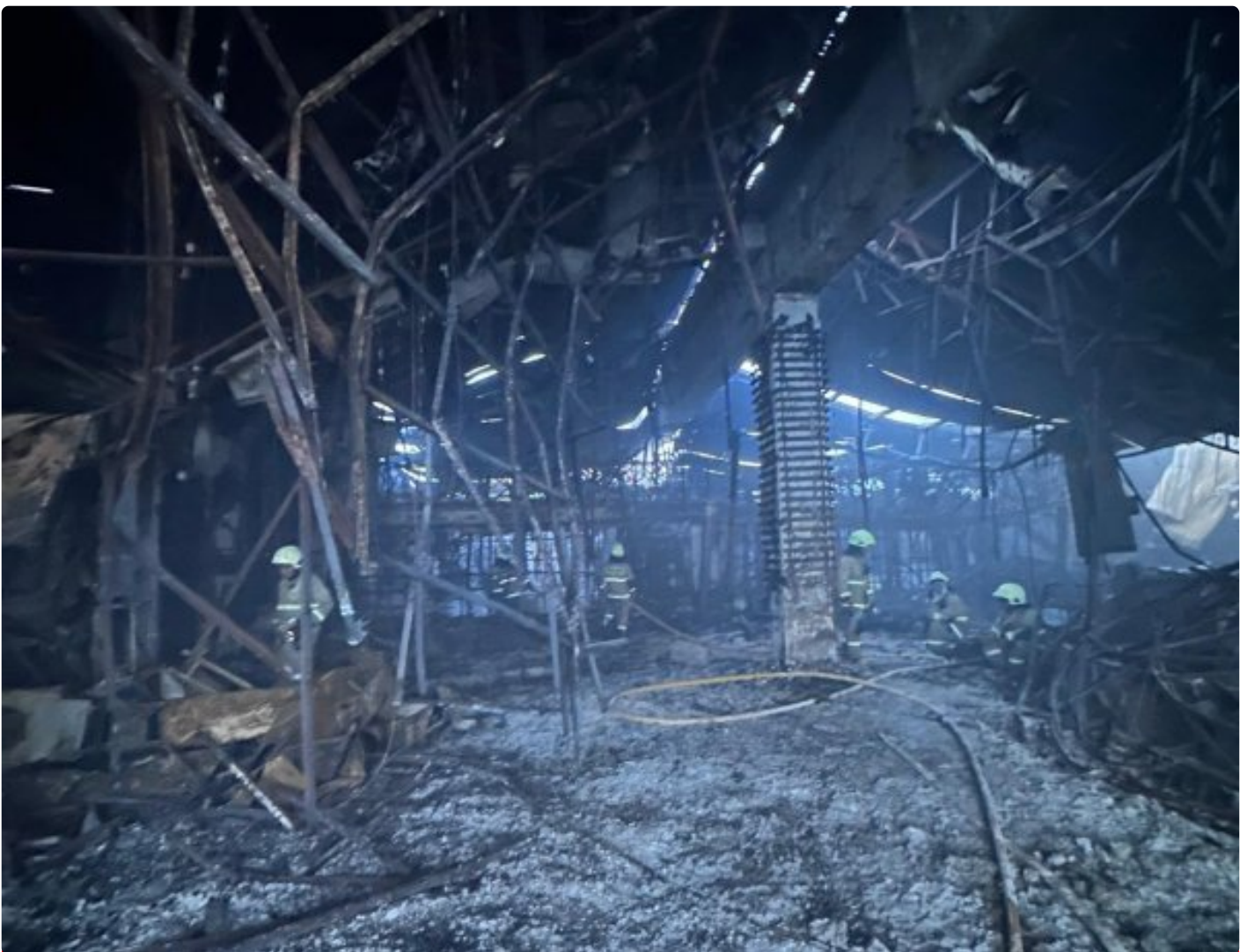
Glodok Plaza yang Hangus Terbakar
